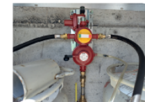
Professionell installierte Flüssiggasanlagen gewährleisten eine sichere Nutzung. (Bild: gwk GmbH)
